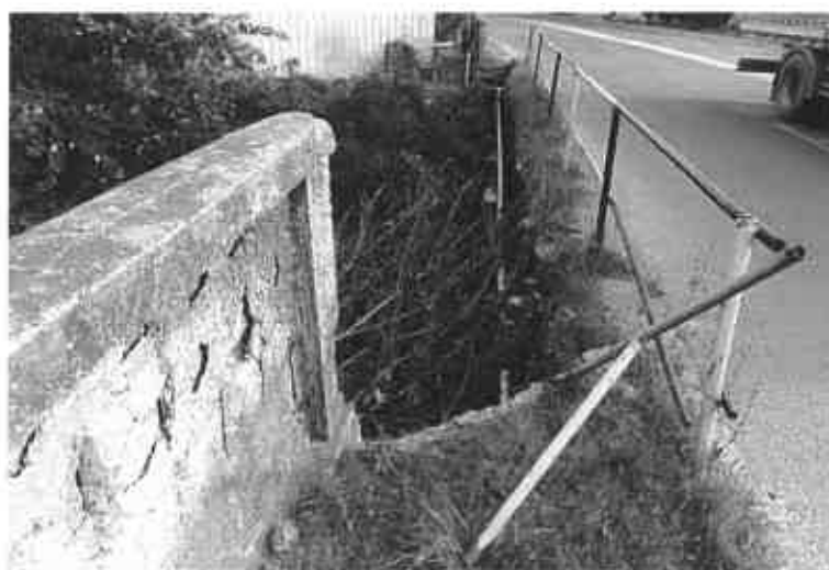
FOTO 14 - Capăt de parapet mal stâng, aval
