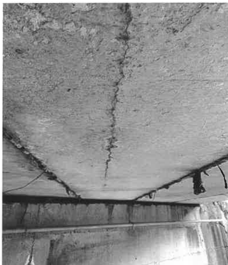
FOTO 19 - Fisuri la fâșile cu goluri
