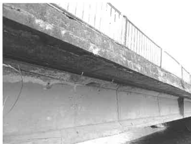
FOTO 11 - Consola trotuar cu infiltrații
