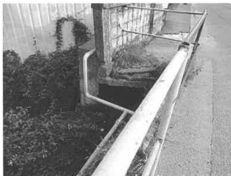
FOTO 11 - Trotuar mal drept, aval
