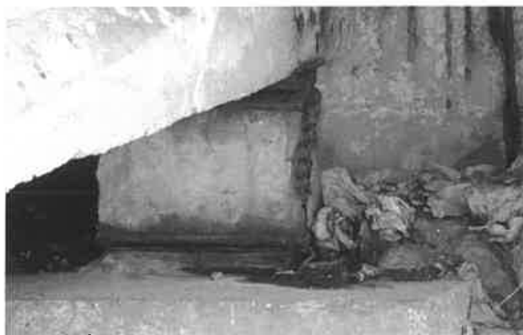
FOTO 15 - Aparat de reazem tip pendul din beton armat
