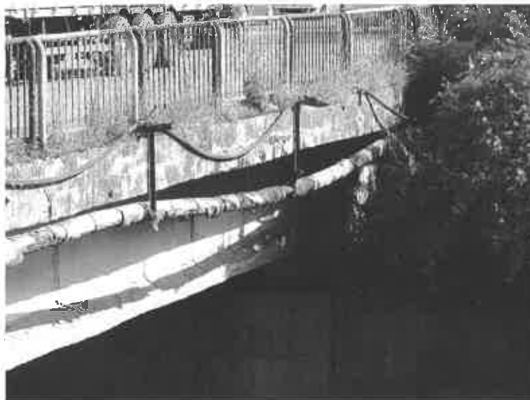
FOTO 16 - Rețele edilitare fixate neconform pe grinda parapet aval
