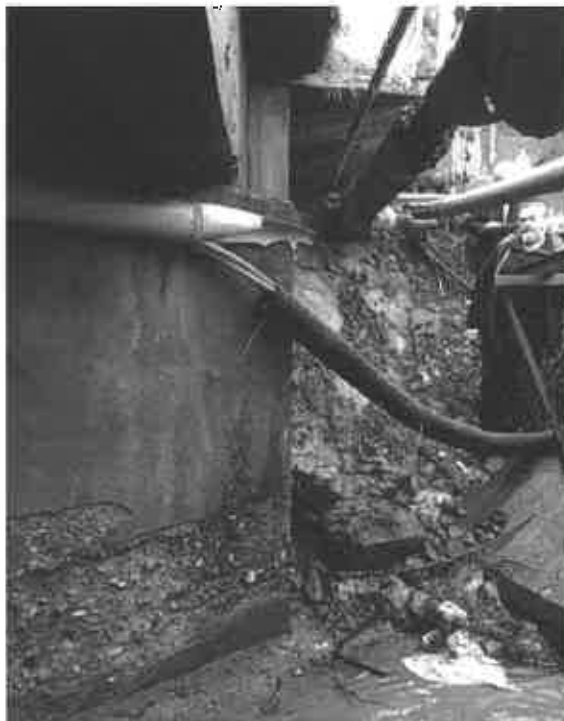
FOTO 25 - Rețele la culeea mal stâng aval
