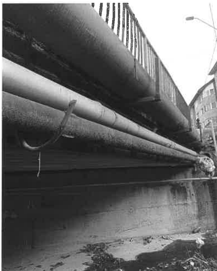
FOTO 24 - Rețele edilitare la trotuar amonte
