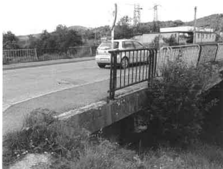
FOTO 9 - Tronson de parapet lipsă
