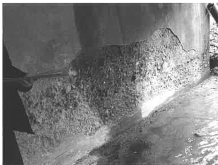
FOTO 21 - Exfolieri la culeea mal drept
