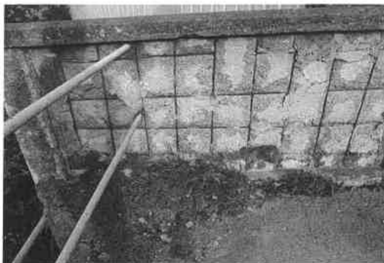
FOTO 12 - Capăt de parapet mal drept, aval
