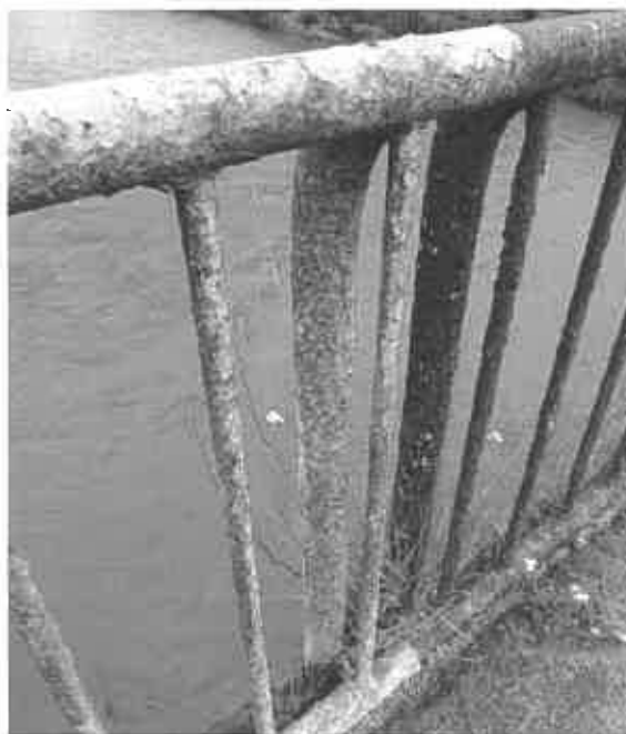
FOTO 5 - Parapet pietonal corodat
