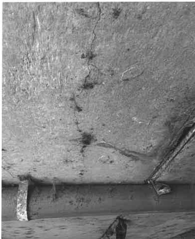
FOTO 18 - Fisuri la fâșile cu goluri
