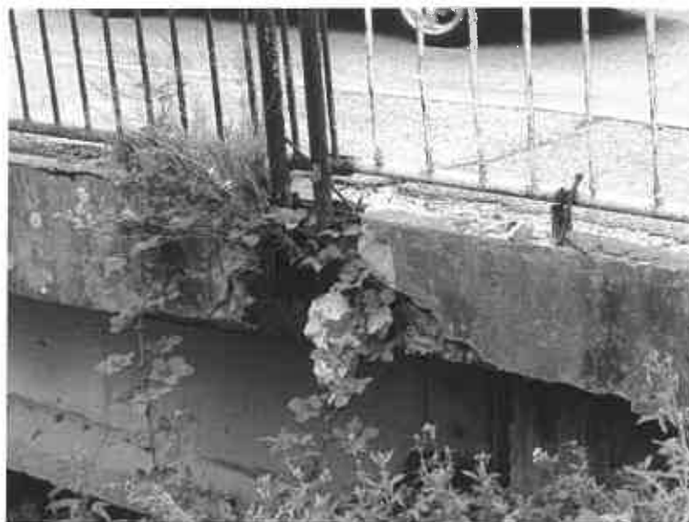
FOTO 7 - Grinda parapet degradată
