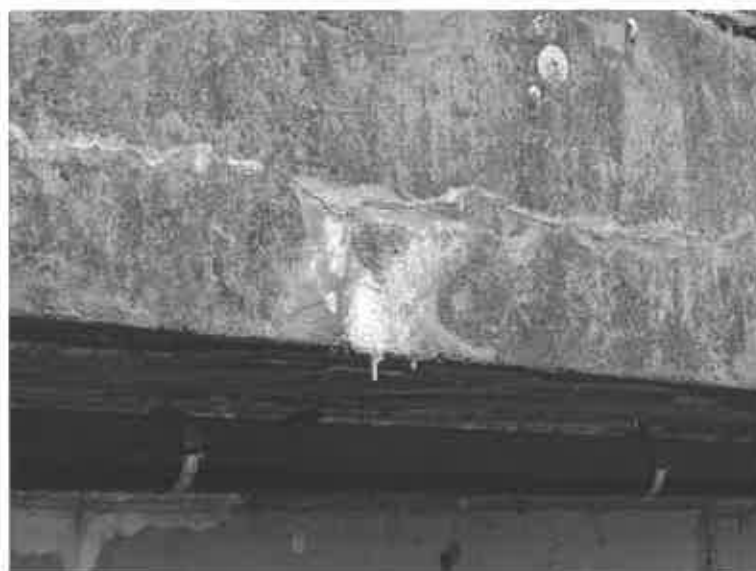
FOTO 10 - Infiltrații la grinda parapet
